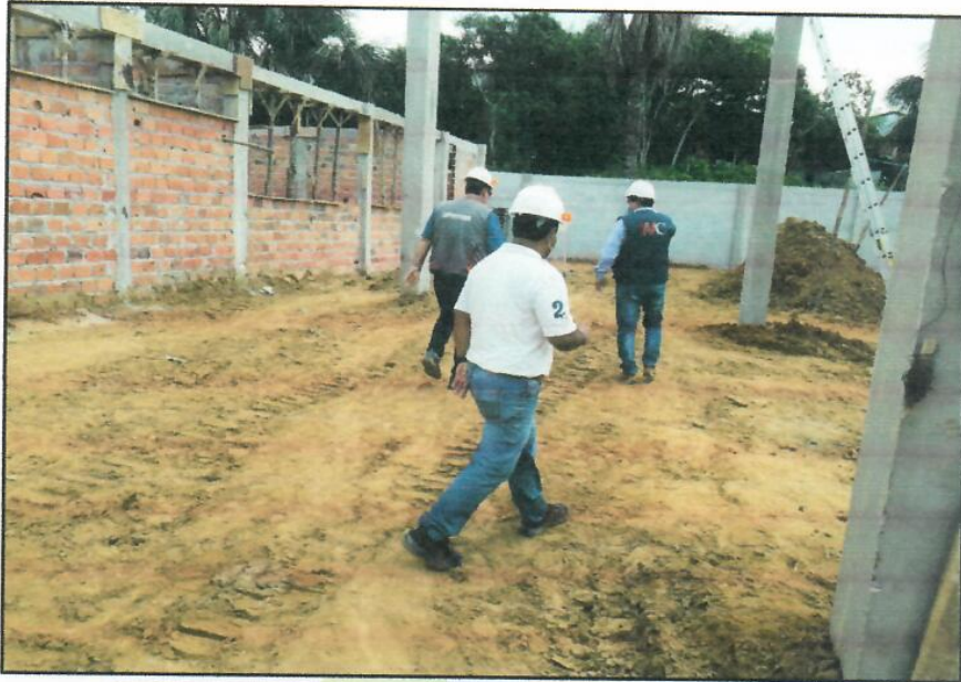
FOTO N°01: RECORRIDO CON LA SUPERVISIÓN PARA VERIFICAR LOS METRADOS EJECUTADOS EN OBRA, SE OBSERVA LOS TRABAJOS EN COLUMNAS Y VIGAS COLLARÍN
