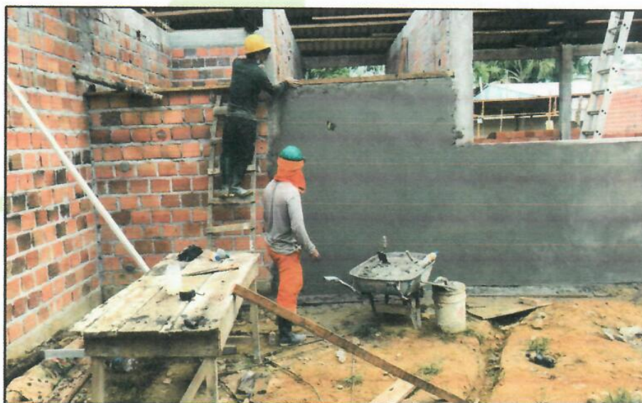
FOTO N°06: TARRALEO EN MURO EXTERIOR EN MODULO IV.
